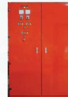
Tủ chữa cháy
