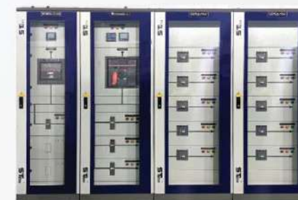
Tủ hạ thế STP
